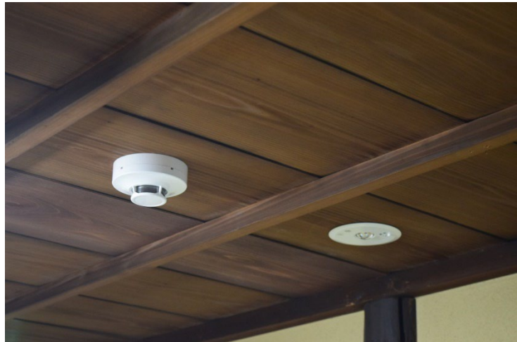
自動火災報知設備
