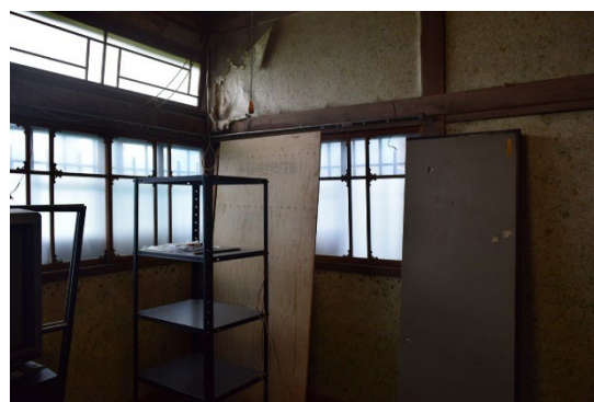
壁仕上損傷部
