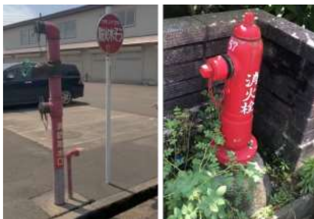
写真 20 与板の防火水槽と消火栓
