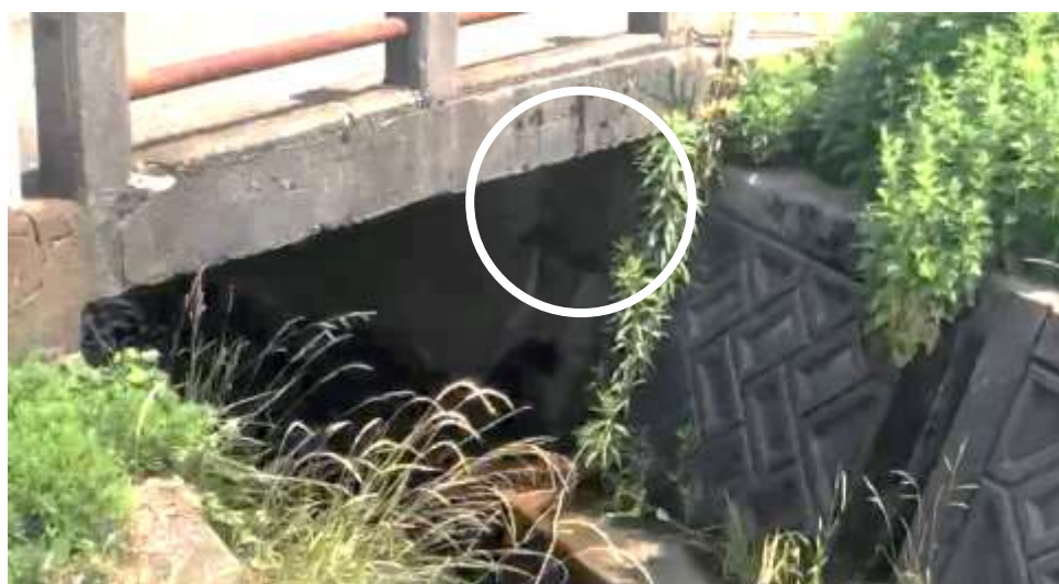
写真 19 橋の下にある穴
